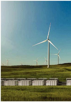
18.17 Deze batterijen in Australië worden opgeladen door windenergie en kunnen dan aan 30 000 mensen stroom leveren.
