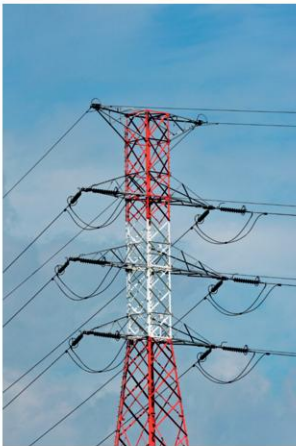
3.1 Hoogspanningskabels zijn niet met de mast verbonden, maar lopen via isolatoren om de mast heen.
