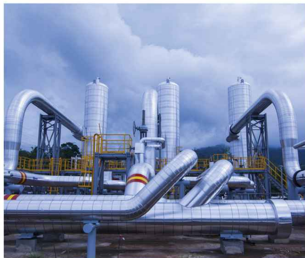
■ Afb. 39 Geothermische elektriciteitscentrale op Sumatra, Indonesië.
